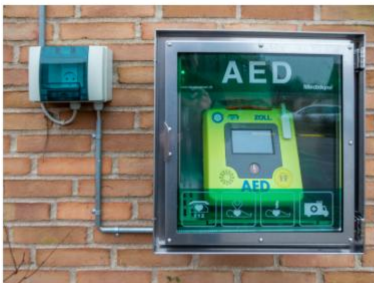
Hjertestarteren på muren ved affaldsøen midt i byggeriet.
